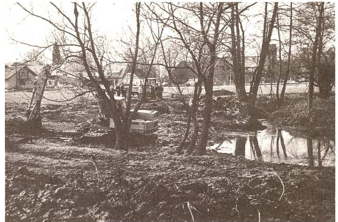
20/21 Überschüssige Gülle verursacht hohe Folgekosten in ökologischer und wasserbaulicher Hinsicht: Schlammبانke eines abgelassenen Mühlenteiches (Kokenmühle, VEC), die ausgebaggert und deponiert werden müssen (Hunteburg, OS).
