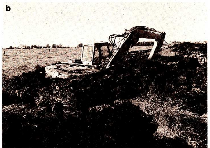
9 Eingesunkener Gruppenbagger nach dem Versuch, Entwässerungskanäle zu baggern.
